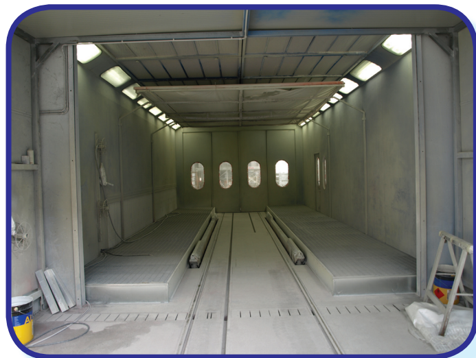
Cabina aspirante di verniciatura dedicata.
