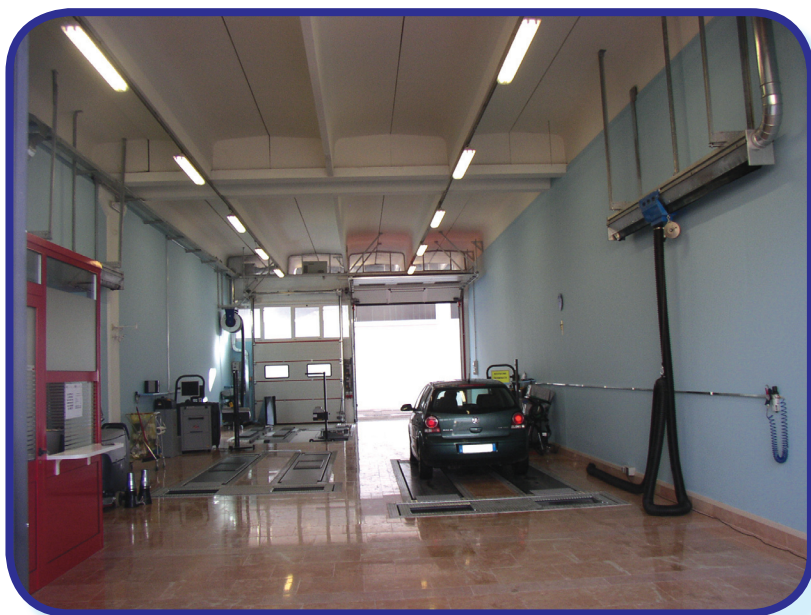
Linea aspirazione gas di scarico per linee revisioni.
